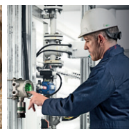
Stationäre Flammen- und Gasdetektion
